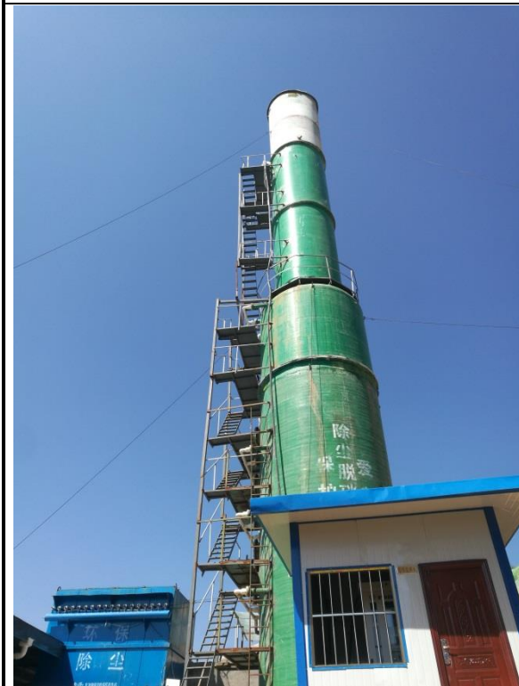
焙烧废气除尘器及脱硫塔
