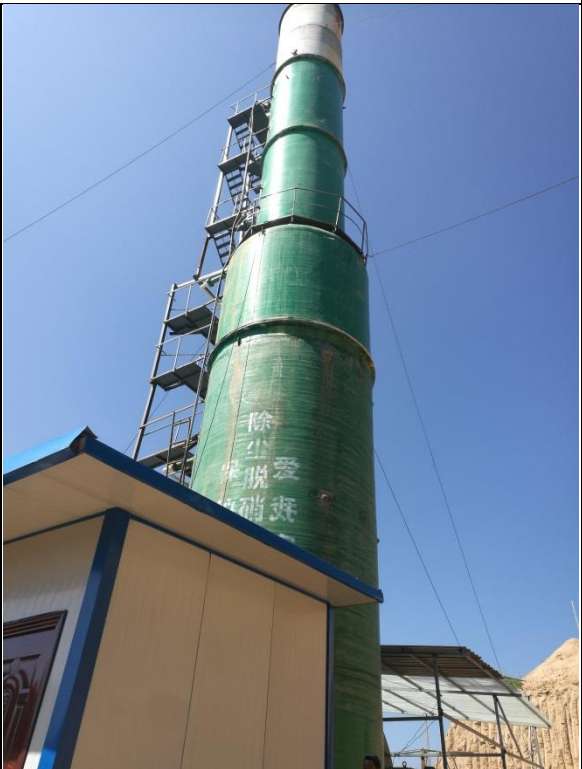
焙烧废气除尘器及脱硫塔
